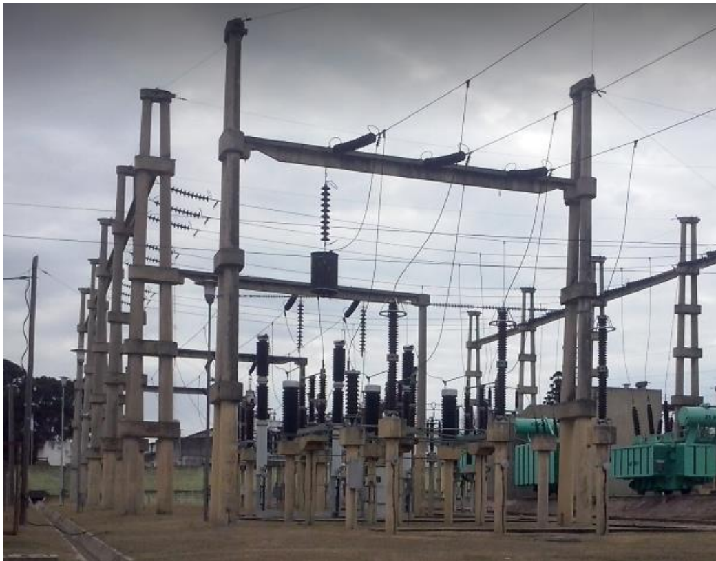
Ilustración 10. Estación transformadora en Av. San Martín. Fuente: lomejordevillacarlospaz.com
